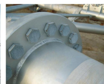
压力管道 Pressure piping
